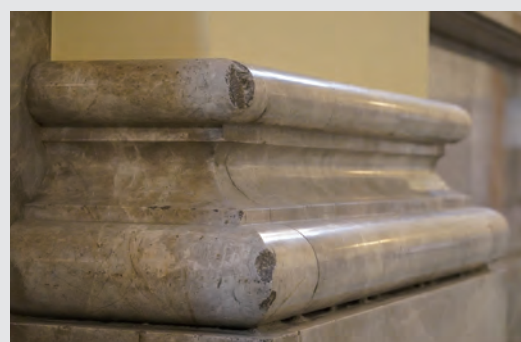
1階窓口の柱の台座。 被爆の影響で角が欠損
