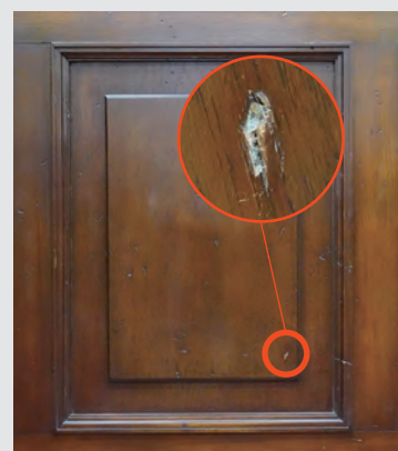
支店長室腰板に残る傷。 ガラス片が残っている部分も
