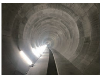
道路下に整備した雨水渠
