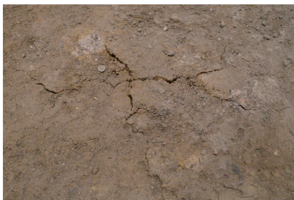
2023/4/24 亀裂 縦約 5.4cm 横約 12.6cm
