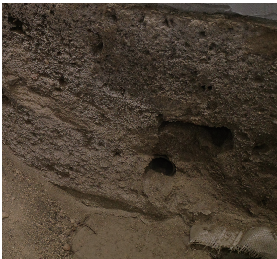
3/13 白い物質析出部分 拡大写真①
