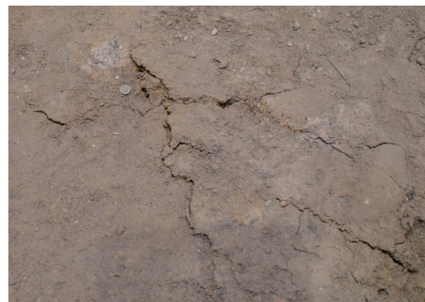
2024/3/13 亀裂 縦約 11.4cm 横約 20cm 前月から大きな変化は見られない。
