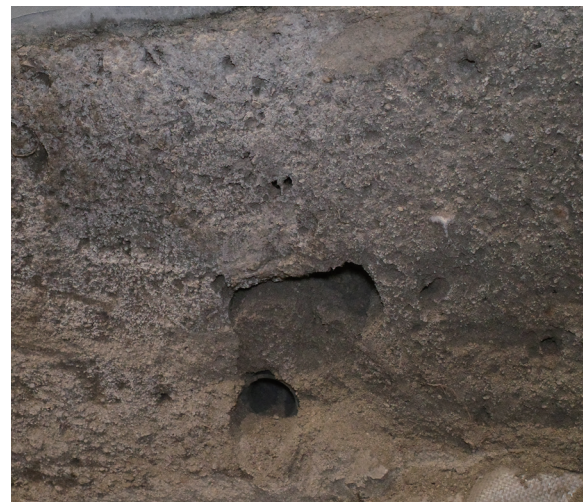
2/15 白い物質析出部分 拡大写真②
