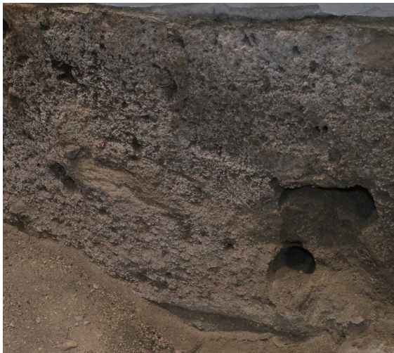
2/15 白い物質析出部分 拡大写真①
