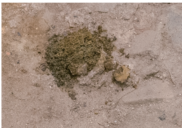
2023/10/13 析出した状況
