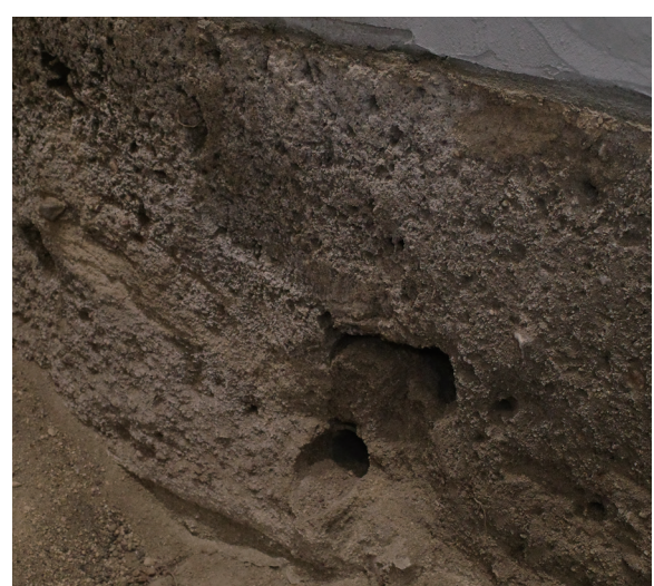
3/13 白い物質析出部分 拡大写真②
