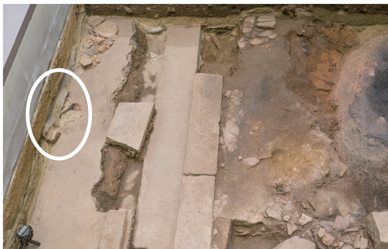
2022/5/16 丸印の部分が崩壊。
