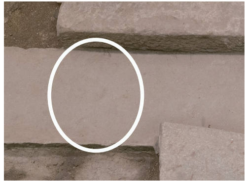
2022/8/24 拡大写真 薄っすらと亀裂が生じている
