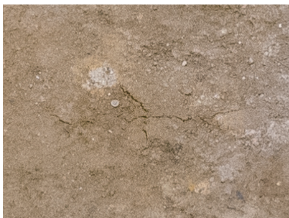
2022/10/13 亀裂 縦約 4.5cm 横約 8.3cm
