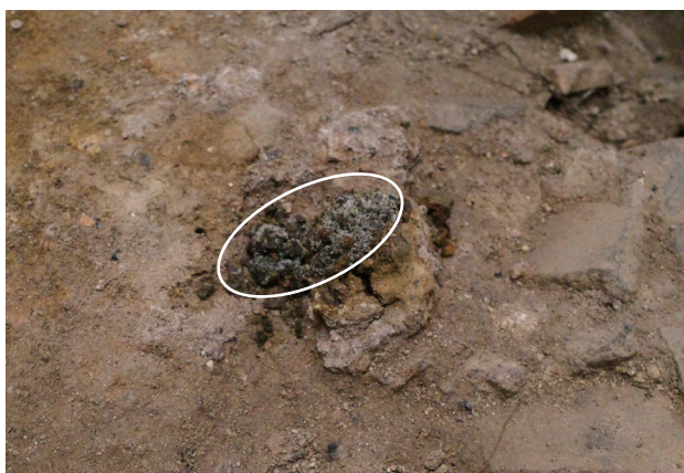
2023/5/16 丸印の部分で、塩が析出か。表層の割れと ともに下層部分が表出。
