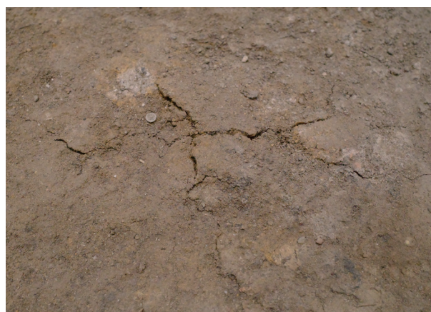
2023/4/24 亀裂 縦約 5.4cm 横約 12.6cm
