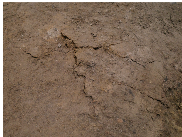
2024/2/15 亀裂 縦約 11.4cm 横約 19.6cm 亀裂が硫酸塩が析出した場所まで広がっている
