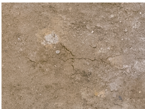
2022/10/13 亀裂 縦約 4.5cm 横約 8.3cm
