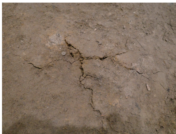
2023/12/15 亀裂 縦約 10.9cm 横約 17.7cm
