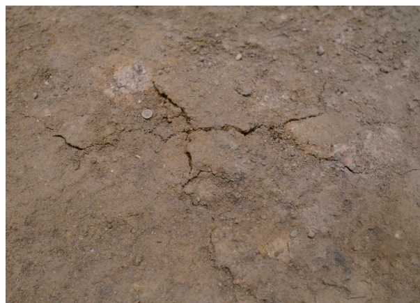
2023/4/24 亀裂 縦約 5.4cm 横約 12.6cm
