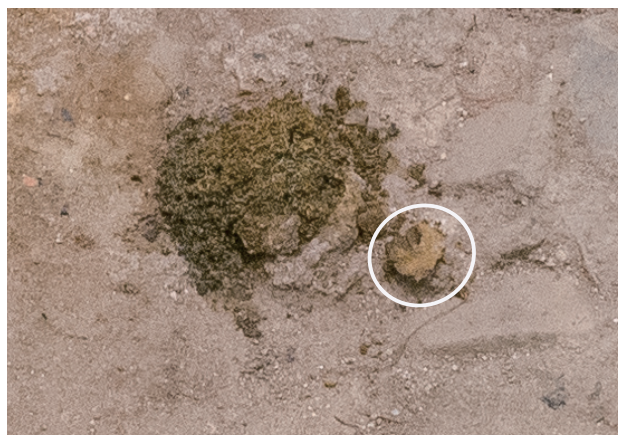
2023/10/13 表面全体が茶色く変化している。 表出した部分※が周囲に崩れ落ちているこ とがわかる。 ※白丸の部分
