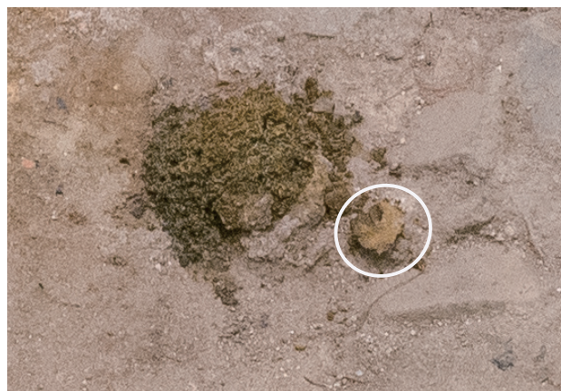
10/13 表面全体が茶色く変化している。表出した部分※が周囲に崩れ落ちていることがわかる。 ※白丸の部分
