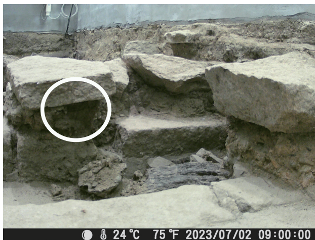
7/2 定点カメラ画像 石列下層部の土層部分の崩壊が進んでいる。
