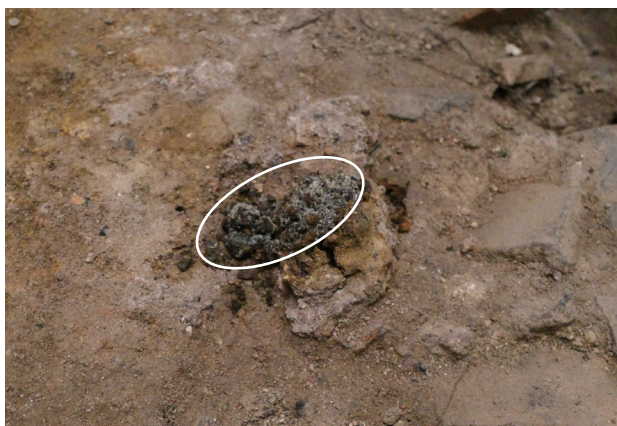
5/16 丸印の部分で、塩が析出か。表層の割れとともに下層部分が表出。
