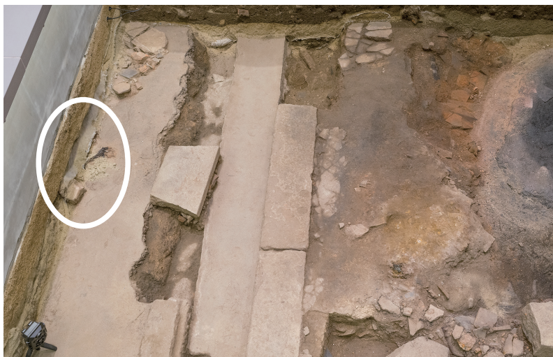
R4/5/16 丸印の部分が崩壊。
