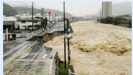
平成30年7月豪雨災害（広島市安芸区）
