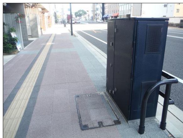
一般的な地上機器 (縦1.1m×横0.45m×高さ1.45m)
