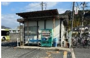
<老朽化した待合施設（郊外部）>
