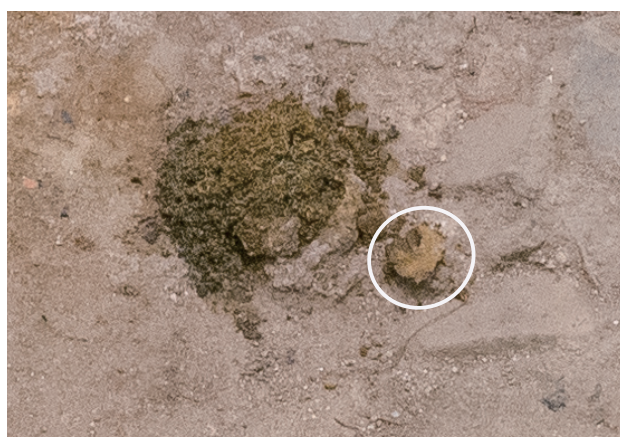
10/13 表面全体が茶色く変化している。 表出した部分※が周囲に崩れ落ちていることがわかる。 ※白丸の部分
