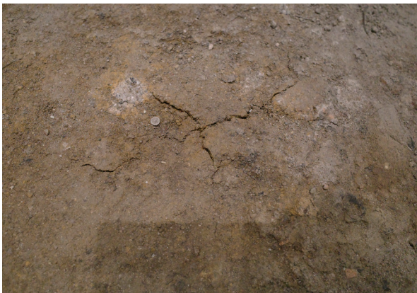
11/16 十字にはっきりと亀裂が入っている。亀裂の範囲が先月よりも広がっている。 亀裂の範囲 東西方向：8.7 cm程度 南北方向：4.2 cm程度
