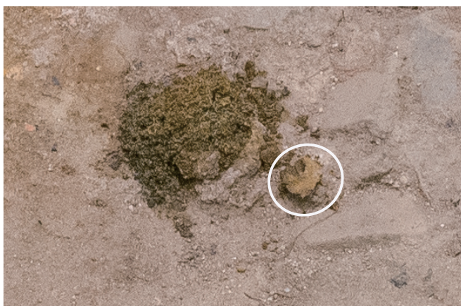
10/13 表面全体が茶色く変化している。 表出した部分※が周囲に崩れ落ちているこ とがわかる。 ※白丸の部分
