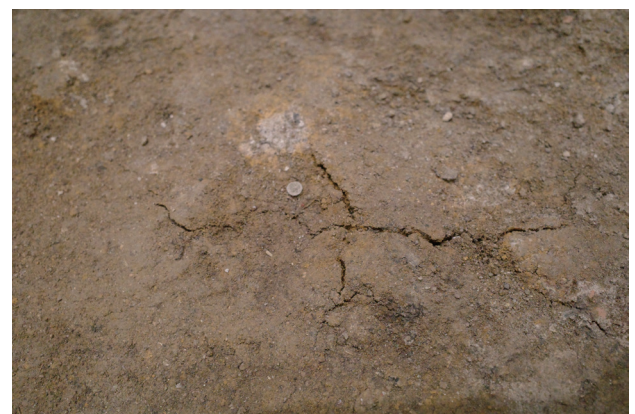
12/14 先月よりも亀裂が深くなっているように思われる。 亀裂の範囲 東西方向：8.7 cm程度 南北方向：4.7 cm程度
