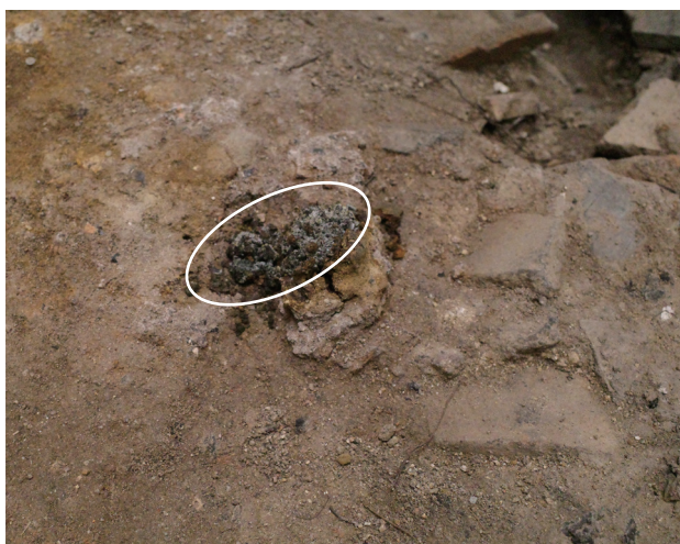
5/16 丸印の部分で、塩が析出か。表層の割れとともに下層部分が表出。
