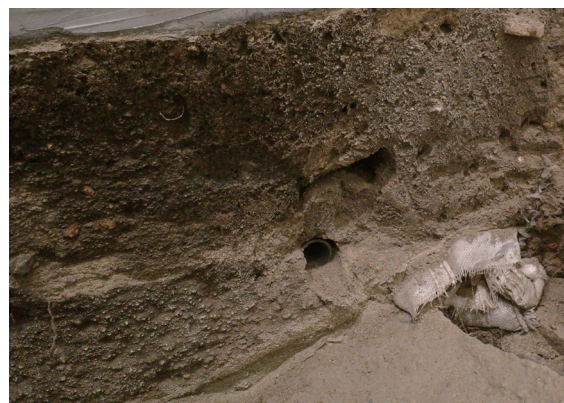
11/16 白い物質析出部分 拡大写真②
