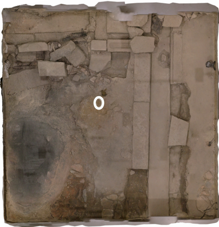
丸印の部分に亀裂が入っている。
