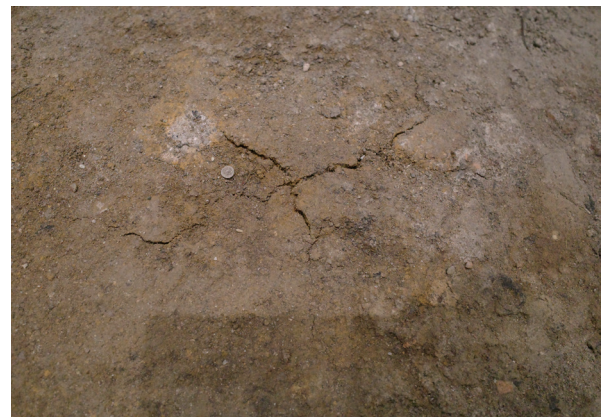
11/16 十字にはっきりと亀裂が入っている。亀裂の範囲が先月よりも広がっている。 亀裂の範囲 東西方向：8.7 cm程度 南北方向：4.2 cm程度
