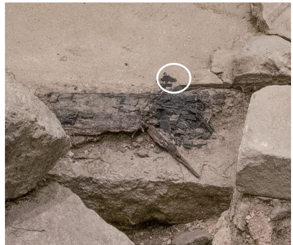
7/14 丸印の部分が5月よりも崩れている。
