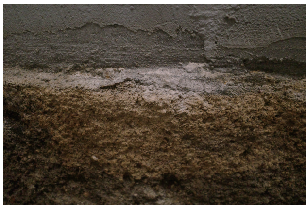
10/13 白い粉状の物質が析出している。
