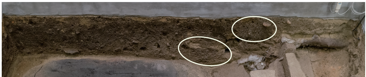
9/14 向かって右側の壁面に白い結晶のようなものが付着している。
