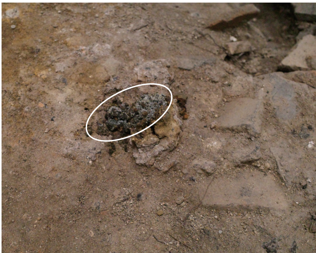
5/16 丸印の部分で、塩が析出か。表層の割れとともに下層部分が表出。
