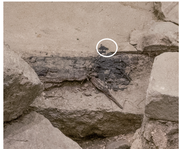
7/14 丸印の部分が5月よりも崩れている。
