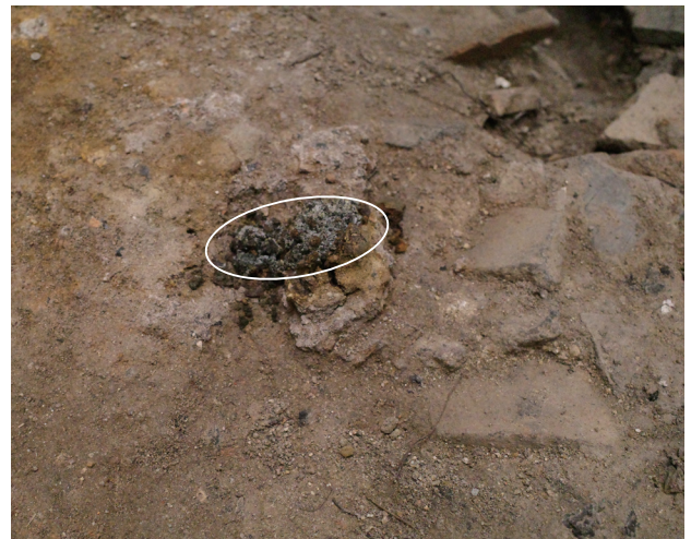
5/16 丸印の部分で、塩の析出か。 表層の割れとともに下層部分が表出。
