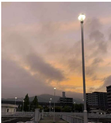
牛田浄水場 LED照明
