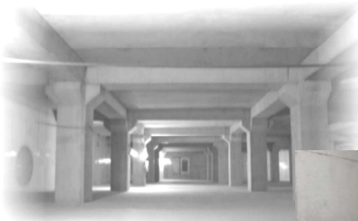
大州雨水貯留池の内部
