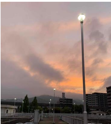
牛田浄水場 LED照明
