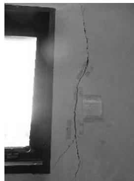
1～2階西側非常用階段壁（亀裂）
