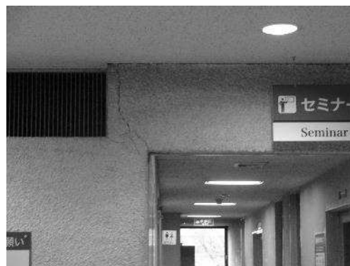
3階セミナー室前廊下（亀裂）
