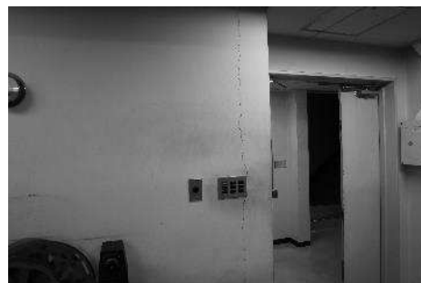
地下1階館内内壁（亀裂）
