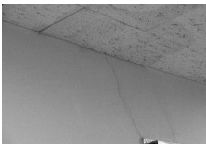
3階セミナー室前倉庫天井（雨漏跡）
