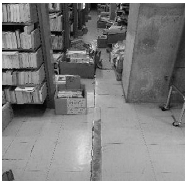
3階書庫床（床の亀裂と床置き書籍）
