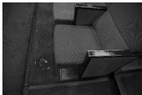
2階上映ホール座席、床劣化
