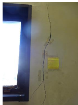
1～2階西側非常用階段壁（亀裂）
