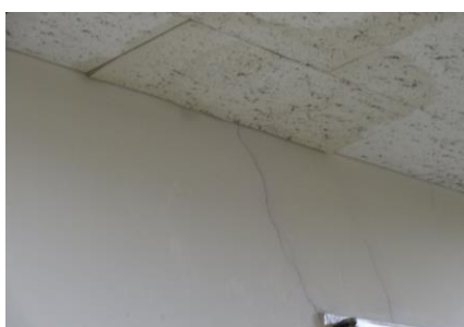
3階セミナー室前倉庫天井（雨漏跡）
