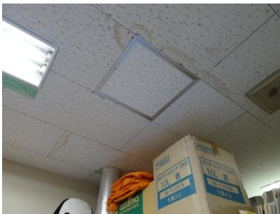
1階事務室天井（雨漏跡）
