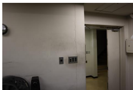
館内内壁（亀裂）
