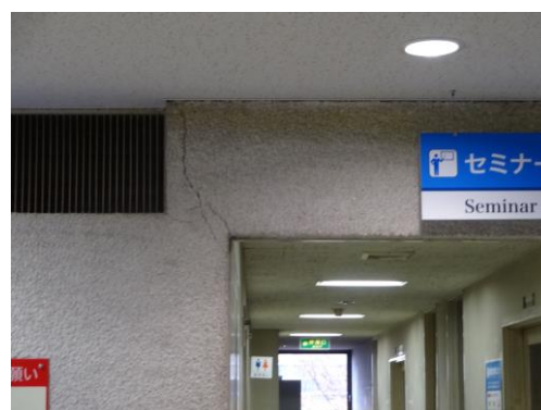
3階セミナー室前廊下（亀裂）
