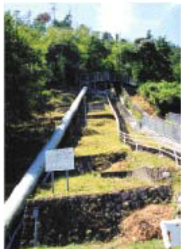
河内発電所に水を送る送水管
