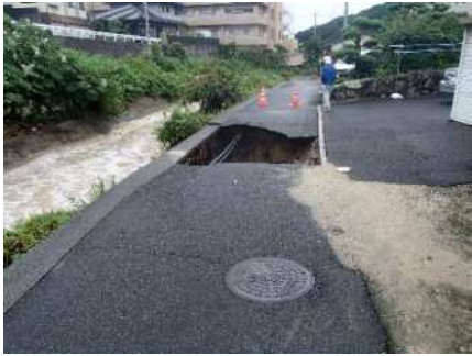
府中大川護岸の崩壊により陥没した道路
