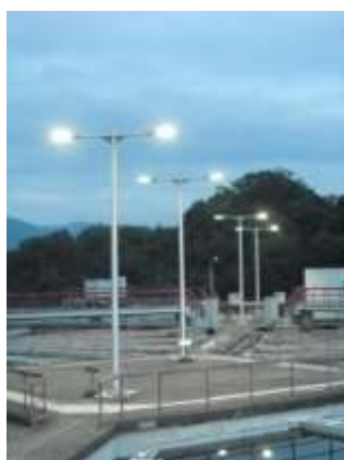
緑井浄水場 LED照明
