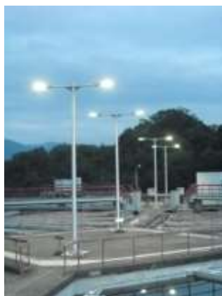
緑井浄水場 LED照明
