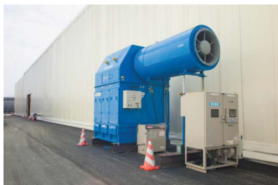
写真 3-5-26 集じん換気装置
