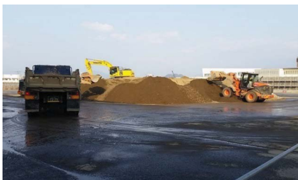
写真 3-5-22 分別土砂保管ゾーン
