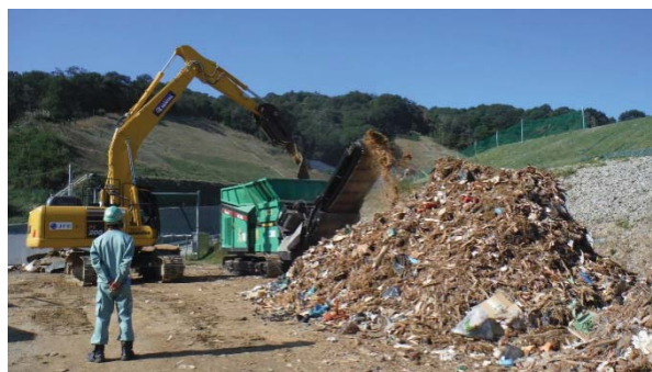
写真 1-2-5 玖谷埋立地内の移動式破砕機
