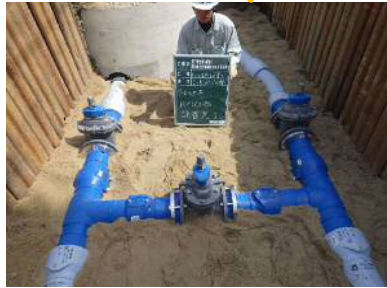
バイパス部設置状況
