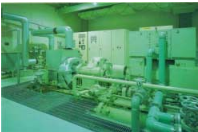
安佐北工場 蒸気タービン発電機
