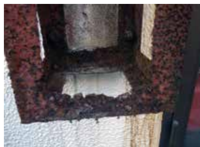
サビによる腐食で劣化が進み、危険な状態になっている ※この看板は所有者が自主的に撤去しました。
