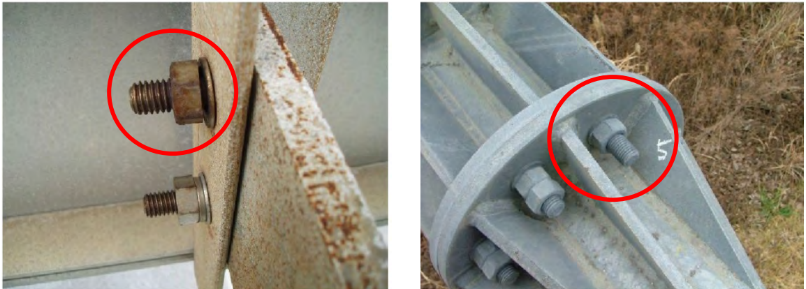
写真 8-9 設置後 10 年以内の附属物の変状事例
