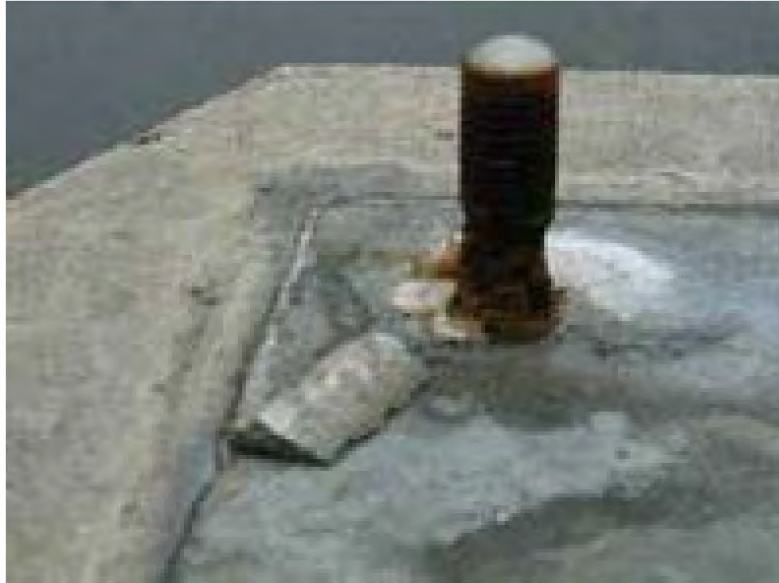
写真 6-2 転用部材のアンカーボルトの変状事例
