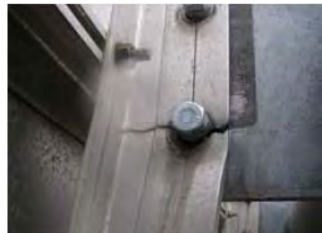
取付部の変状状況
