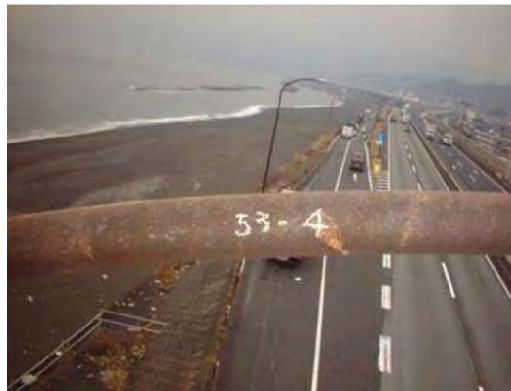
写真 8-11 支柱本体の腐食事例
