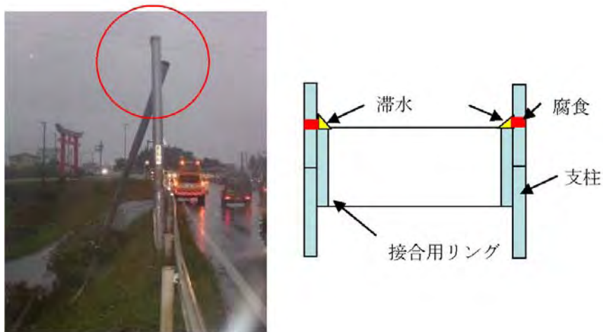
写真 8-7 支柱継手部の折損状況
