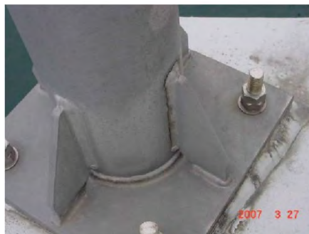
標識柱基部溶接部のき裂
