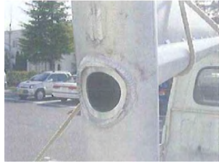
アルミ製デザイン照明柱横梁アーム落下 （強風により発生）
