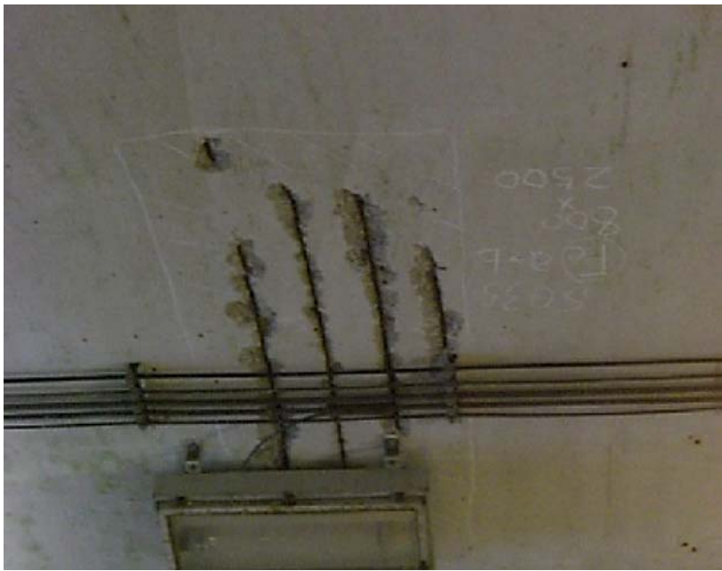
付写真 鋼材腐食の例
