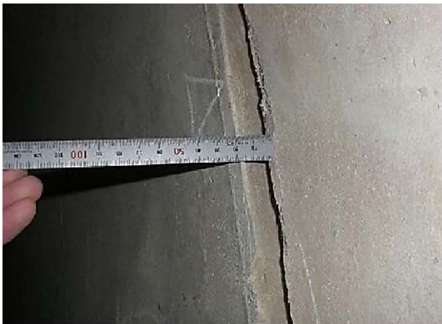
付写真 段差の例
