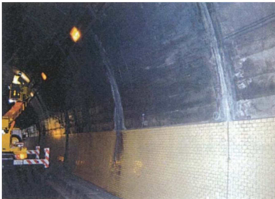
付写真 覆エスパンの中間付近に発生したひび割れの例
