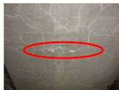
貫通ひびわれあり
