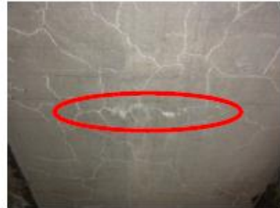
貫通ひびわれあり
