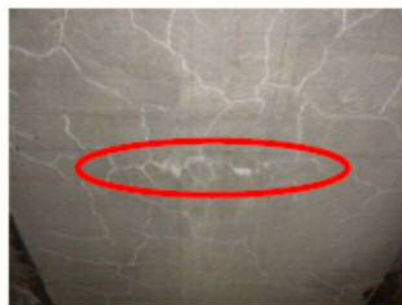
貫通ひびわれあり
