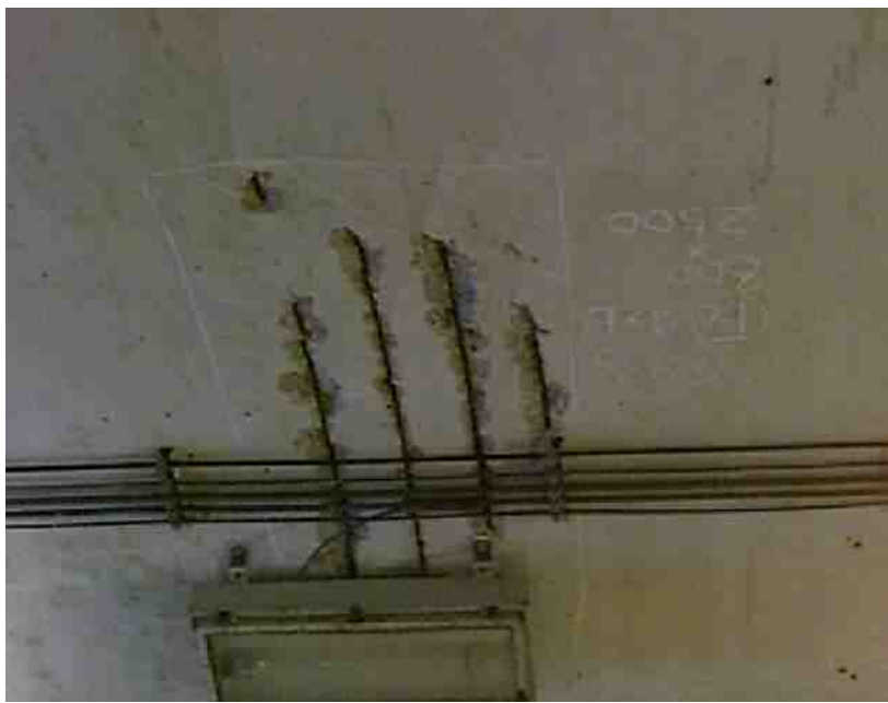
付写真 鋼材腐食の例
