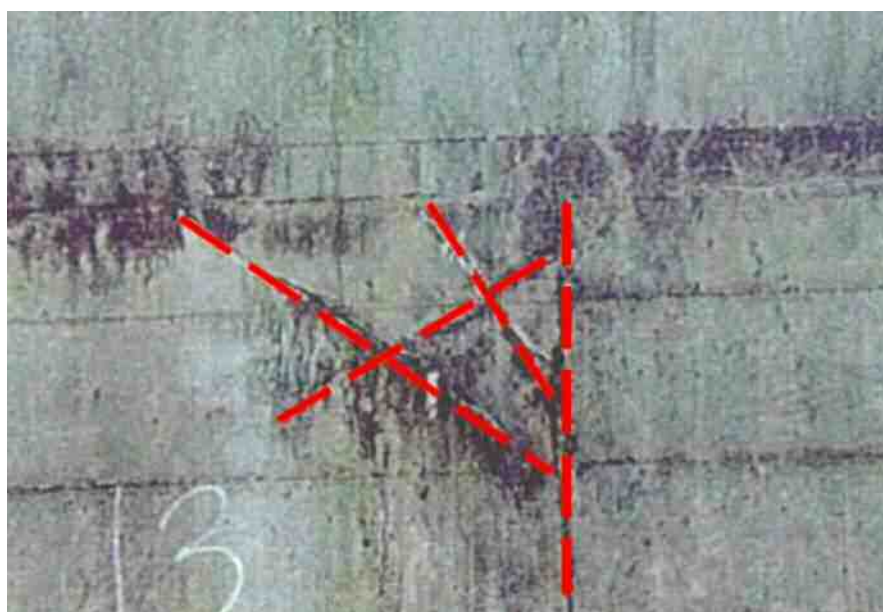
付写真 ブロック化したひび割れの例
