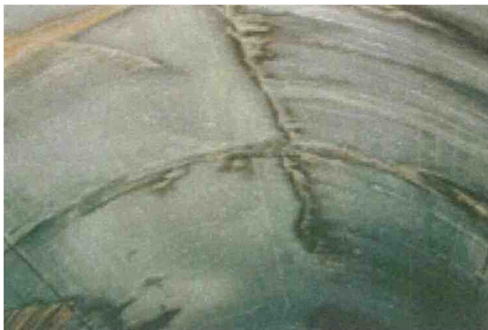
付写真 覆工の天端付近に発生した縦断方向のひび割れの例
