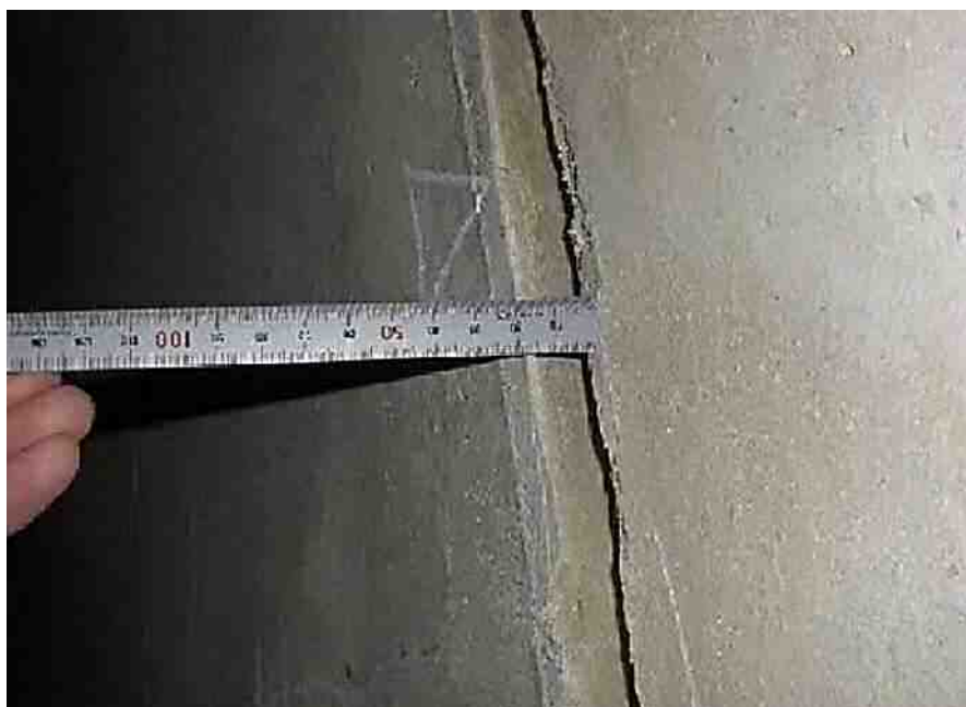
付写真 段差の例
