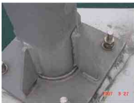
標識柱基部溶接部のき裂
