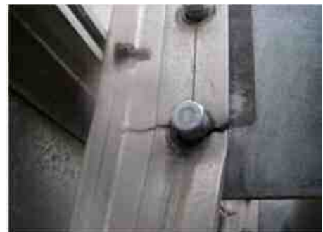
取付部の変状状況
