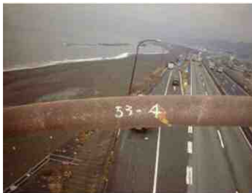
写真 8-11 支柱本体の腐食事例
