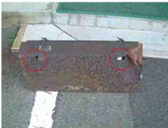
落下照明背面状況
