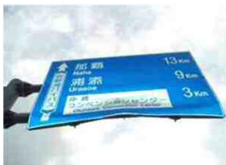
道路標識板の変状事例
