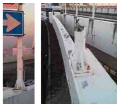
点検用開口部の破断による落下 （高架橋、設置後 21 年経過）
