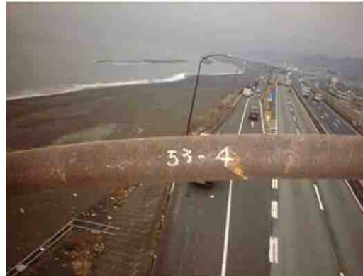
写真 8-7 支柱本体の腐食事例
