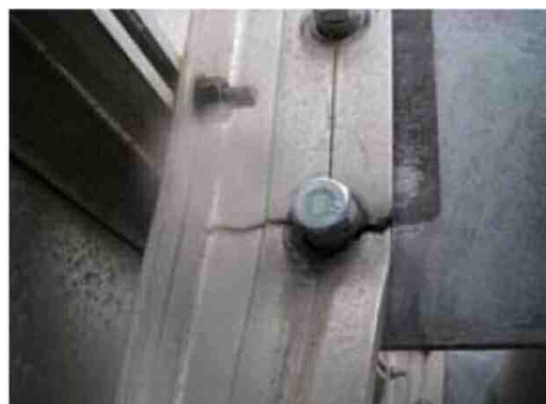
取付部の変状状況
