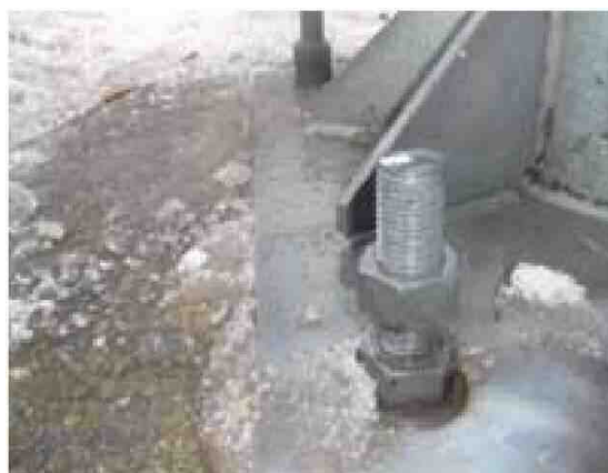
写真 6-1 設置後 1 年程度の附属物のアンカーボルトのゆるみ
