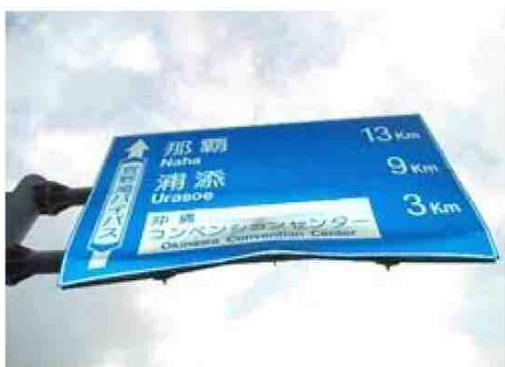
道路標識板の変状事例
