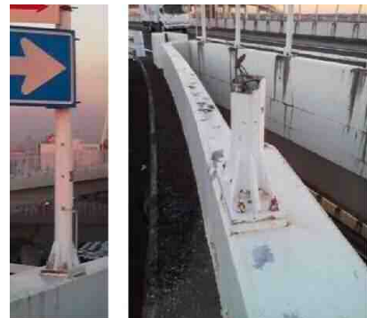
点検用開口部の破断による落下 （高架橋、設置後21年経過）
