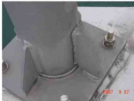
標識柱基部溶接部のき裂
