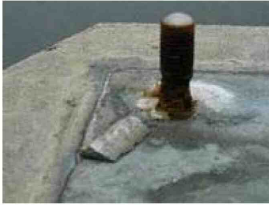
写真 6-2 転用部材のアンカーボルトの変状事例
