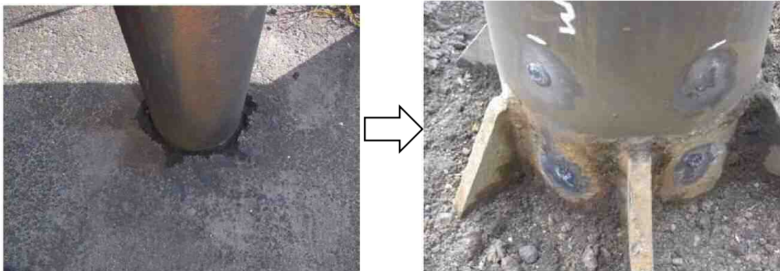
腐食、路面付近での滞水
