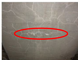
貫通ひびわれあり
