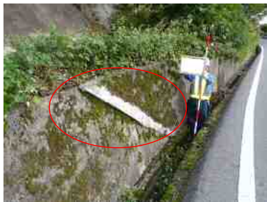
写真では亀裂補修後もせり出しが進展している
