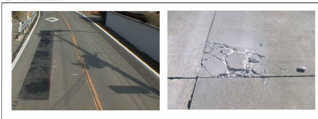
(占用復旧跡の沈下)
