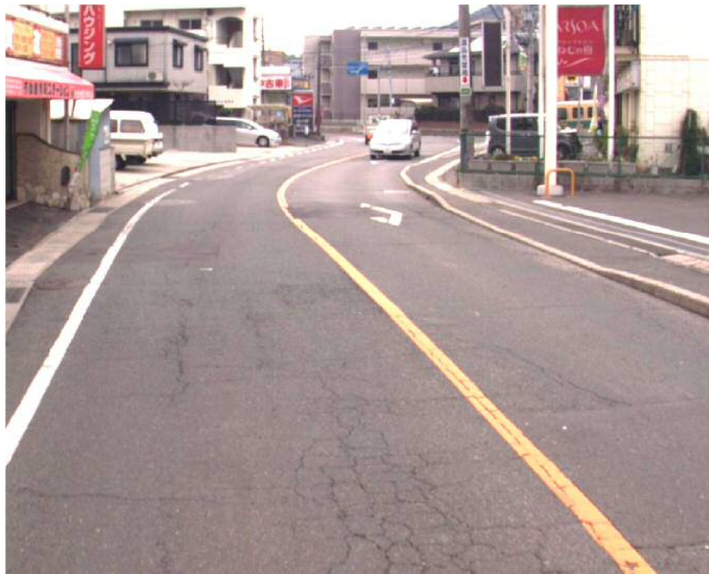
〈写真 6-1〉MCI3 程度の路面
