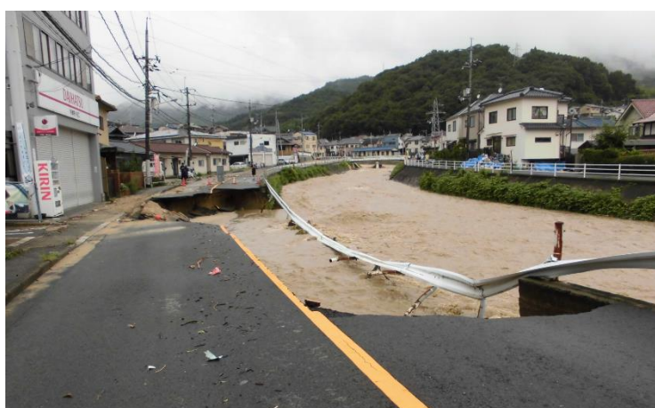
図-10 平成 30 年 7 月豪雨における被災状況
