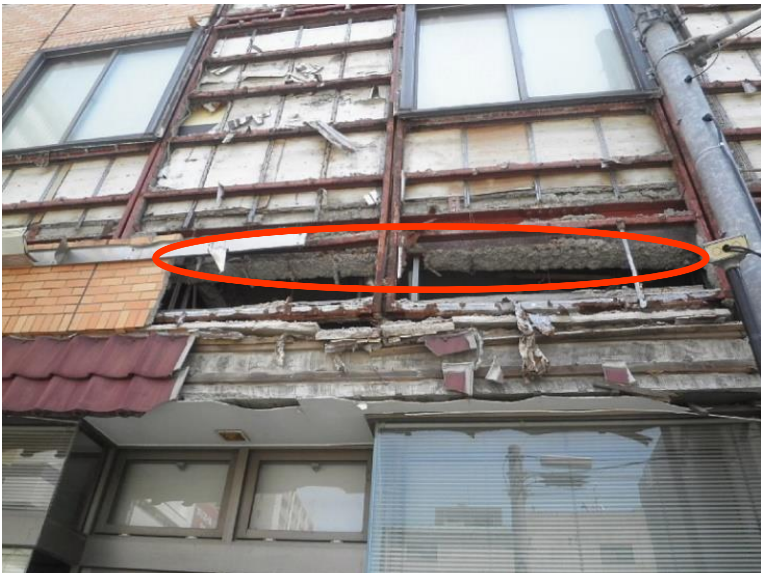
壁材崩落により露出した吹付け材
