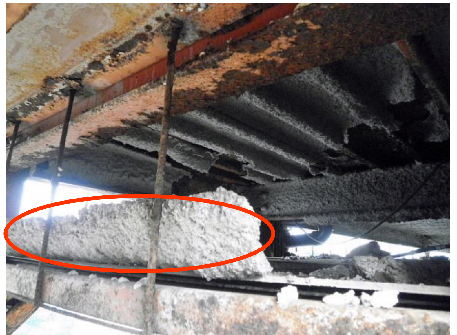
破損し落下した吹付け材
