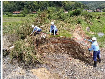
河川の被災状況調査(山口県美祢市)
