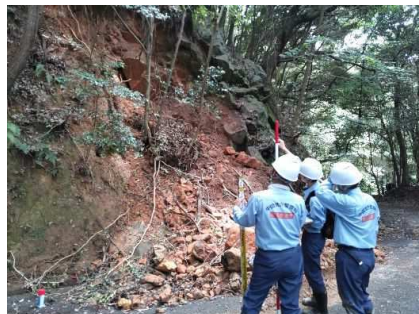
道路の被災状況調査(山口県美祢市)
