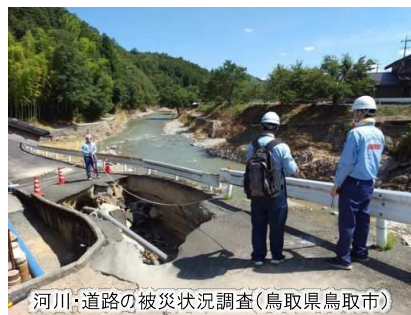
河川・道路の被災状況調査(鳥取県鳥取市)
