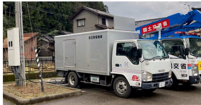
電源車が配置され応急対応が完了 (輪島市 浦上公民館)
