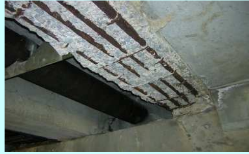
主桁の鉄筋露出
