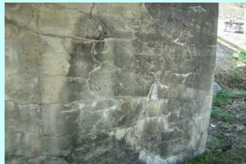
橋台のひび割れ
