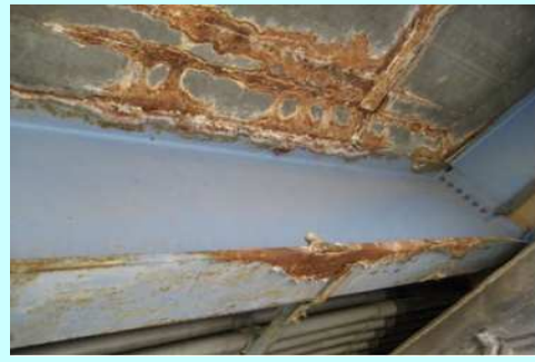
床版のひび割れから錆汁の発生
