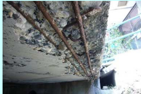
床版の鉄筋露出
