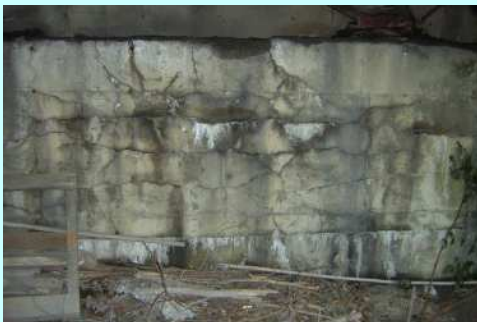
橋台のひび割れ
