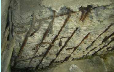
床版の鉄筋露出
