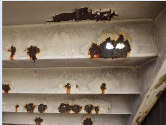
階段部の腐食、貫通
