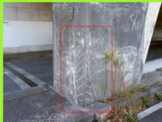
谷側柱部のうき
