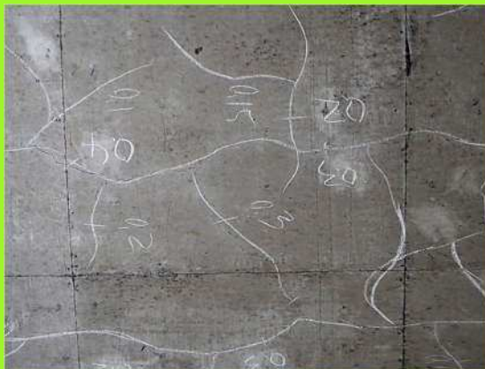
頂版のひびわれ
