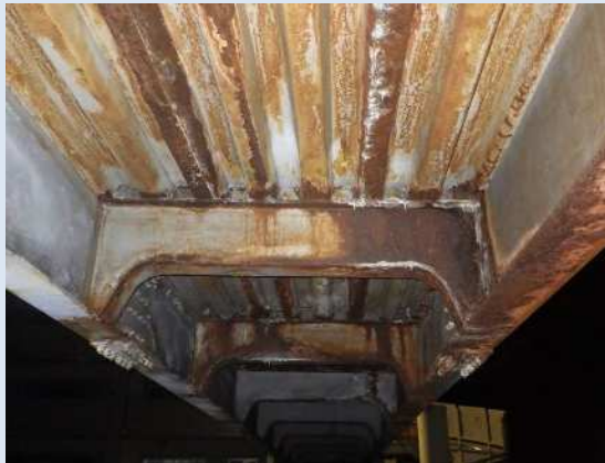
デッキプレートの腐食
