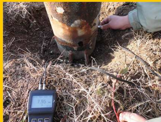
柱脚部（路面境界部）の腐食、貫通
