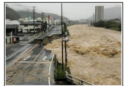
国道2号 H30年7月豪雨被災状況
