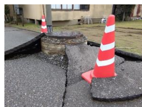
地震によるマンホールの浮上
