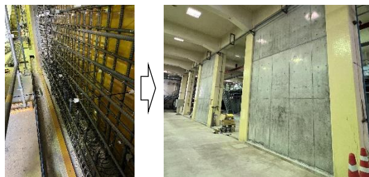
大州ポンプ場（令和5年度）
